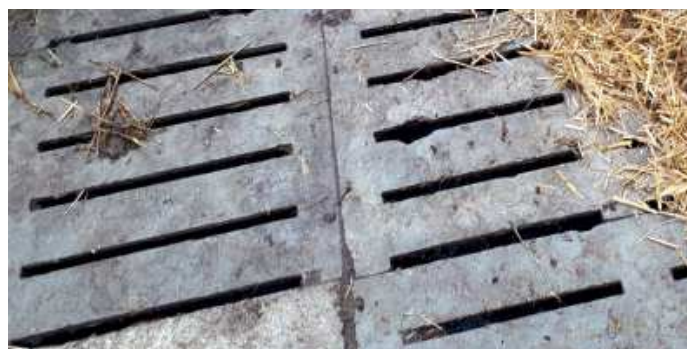
Figure 4: Les caillebotis dont les fentes sont cassées doivent être remplacés
